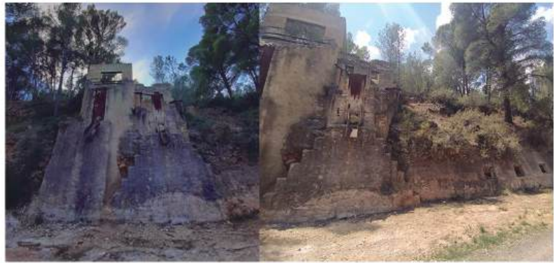
1. Silo de descarga pequeño 2. Silo de descarga grande
